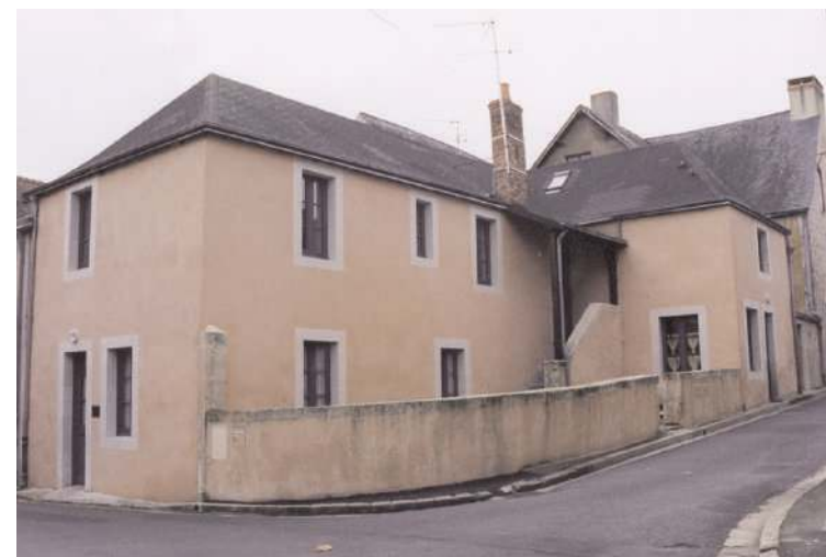
Deux maisons anciennes (probablement XV ème ) regroupées, ont été modifiées dans leur volumétrie (toitures), les ouvertures, et les matériaux (ardoises bitumées, enduit gratté). Elle a perdu tout caractère architectural. Seul l'escalier extérieur témoigne de l'époque de construction.
